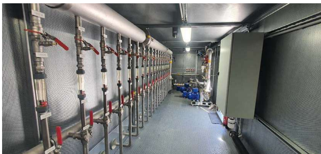
9 – Vista interior da nova central de comando do sistema de recolha de biogás
