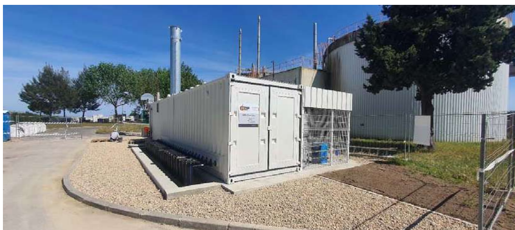
8 – Nova central de comando do sistema de recolha de biogás
